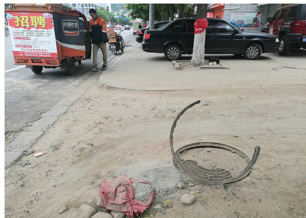
城市建设好,但速度、防护等需要跟上。图为离石长治路的一处建设现场,不仅拖了好长时间,而且地下管网的检查并更换上新的、旧的废弃物仍然遗留一部分,给过往行人造成了安全隐患。 李小明 摄
