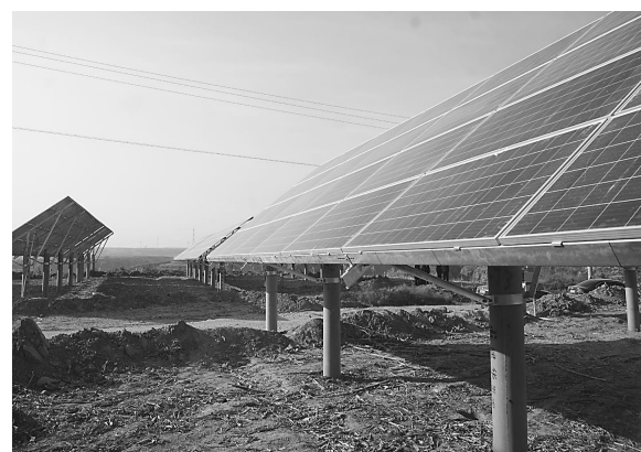
临县白文镇34MWp光伏扶贫项目如期完工，2018年11月30日并网发电。图为项目一角。 李小明 摄
