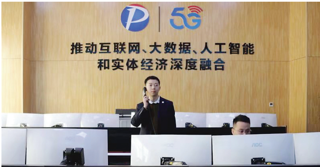
利用5G技术,工作人员一边连线,一边观看距离总部115公里以外常信煤矿地下200米中央变电所的实时画面
