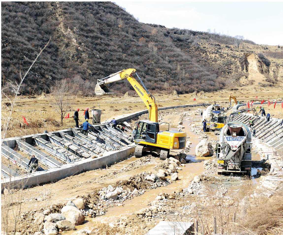
4月6日,方山县瓦窑河生态综合治理二期项目建设现场热火朝天。主要治理工程位于方山县圪洞镇圪洞沟,内容为河道新建护岸,治理长度9.43千米。瓦窑河(圪洞沟)是北川河的一级支流,位于北川河上游东部,发源于方山县圪洞镇境内的阳台台林场,自东向西流经圪洞镇郭家湾村、武家湾村、秀云塔村、阳湾村、高家庄村、圪洞村等6个村,在圪洞镇圪洞村注入北川河。工程建成后,将显著提升瓦窑河治理段生态环境,保障区域安全,调节局部地区气候,促进生物多样性恢复,显著提高居民生活环境质量。杨应平 摄
