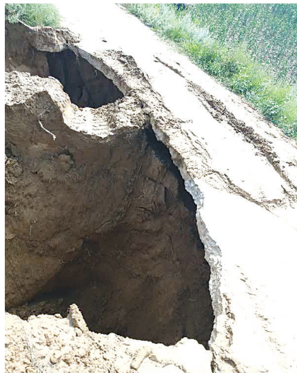
一处坍塌的乡间路
