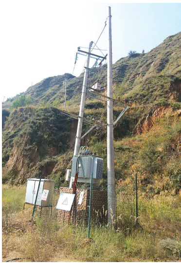
被损坏的一处电力设施
