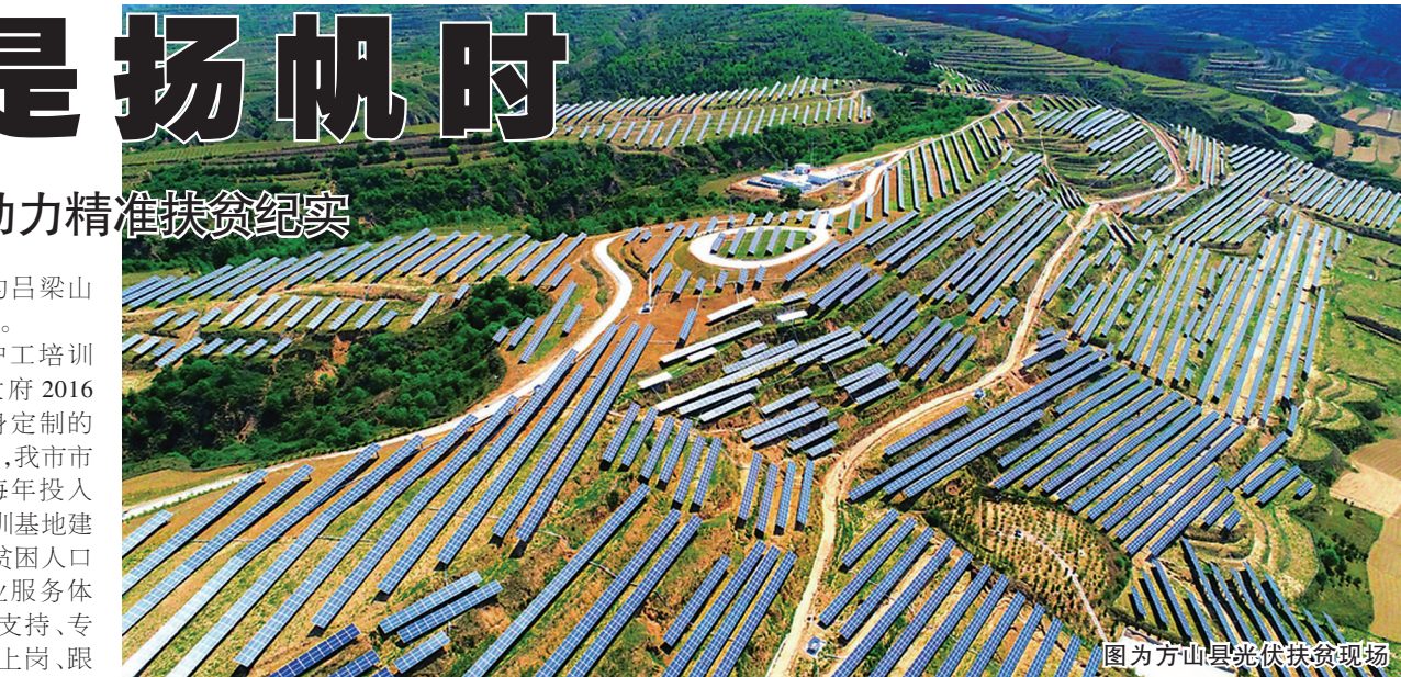
图为方山县光伏扶贫现场
