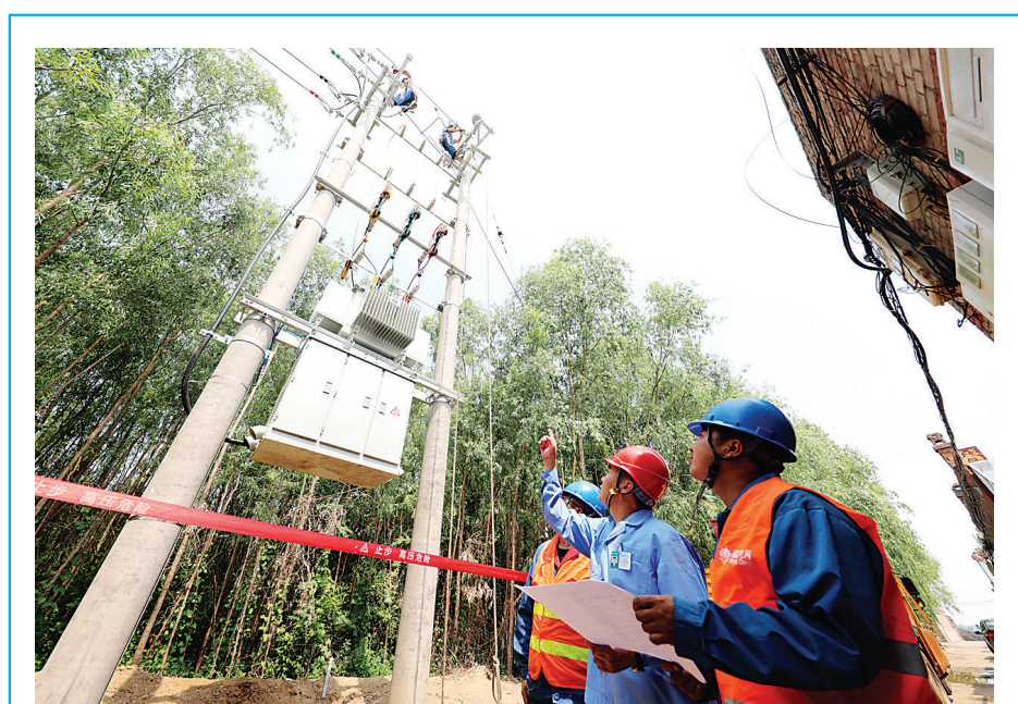
国网山西电力共产党员服务队到辖区居民家中,检查用电设施,提供用电服务
