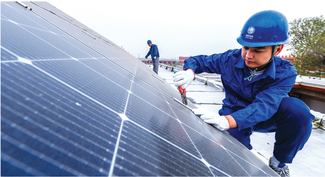
11月16日,在肥乡区毛演堡乡崔庄村,邯郸市肥乡区供电公司员工在检修屋顶光伏设备。近年来,河北省邯郸市肥乡区积极探索光伏扶贫模式,推进乡村家庭屋顶光伏惠民工程。该工程采用“全电上网”模式,将村民屋顶光伏所发的清洁电能全部并入地方电网,拓宽贫困群众增收渠道。
