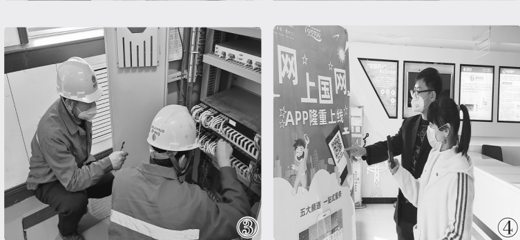
图①:服务队队员检查排灌线路和设备,保证春耕春灌正常进行。 图②:供电所派专人上门对复工复产企业变压器进行红外测温,排查隐患。 图③:工作人员在35KV楼西变电站检查保护通信设备。 图④:营业厅服务人员引导客户网上办理查询、缴费、报修等办电业务。
