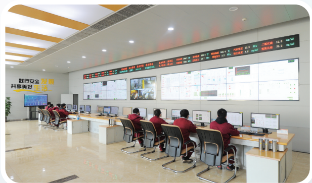
晋能大土河热电有限公司主控室,工作人员在监测数据
