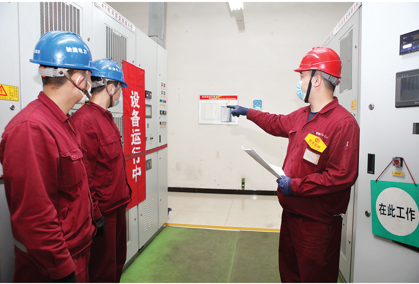
6月16日,晋能集团安全监察员正在对检修人员进行检修前的设备安全提示。
