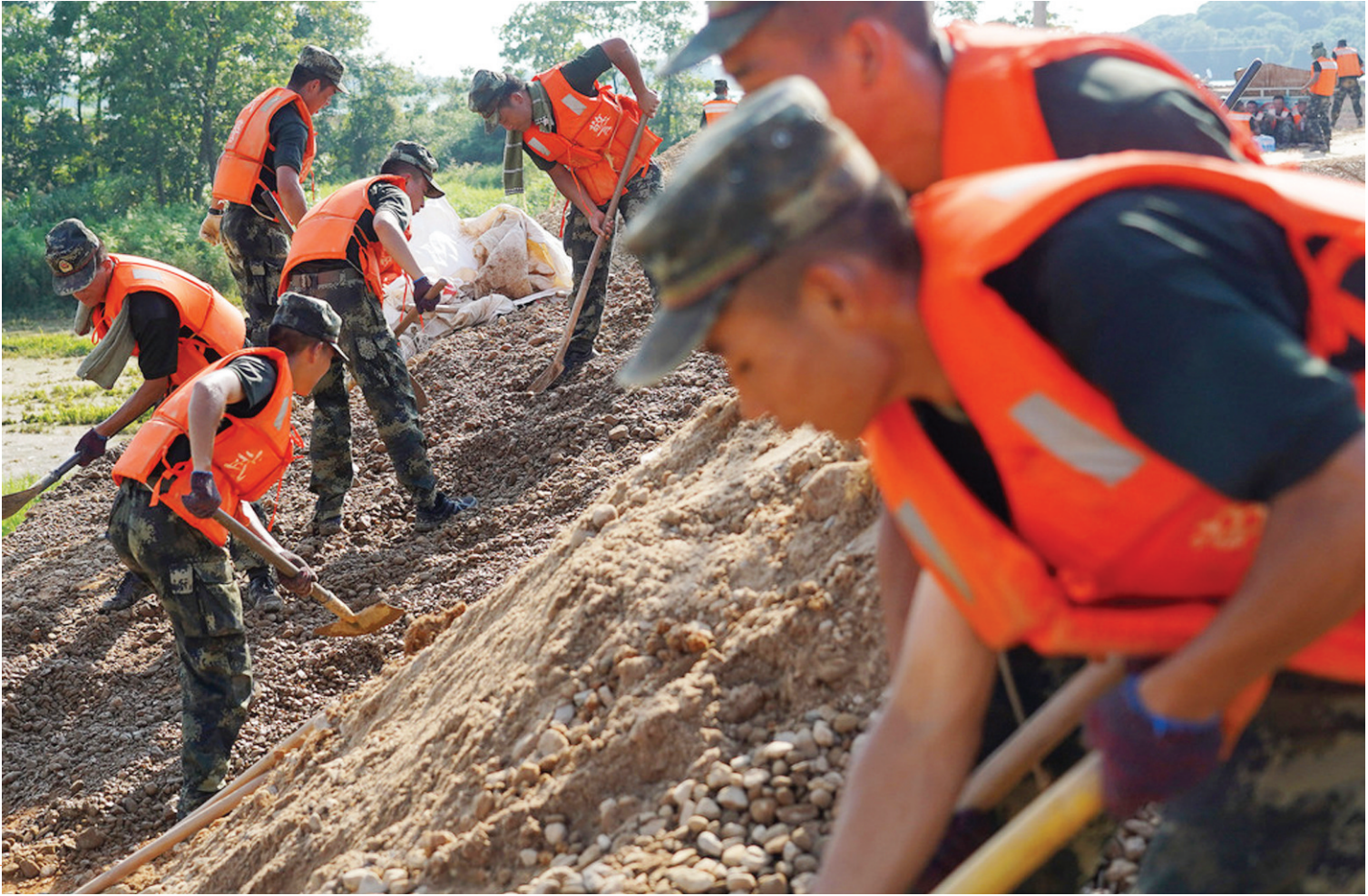
武警江西总队上饶支队的官兵在处置一处堤坝坍塌险情(7月14日摄)。 开挖导渗沟、填埋沙石、疏通排水渠、垒填沙袋,汗水划过脸颊,浸湿军装。在位于江西省余干县古埠镇的齐埠联圩上,武警江西总队上饶支队的60名战士头顶烈日,挥汗如雨,在泥水中处置一处堤坝坍塌险情。在这群平均年龄只有21岁的年轻战士中,最小的只有18岁,其中“00”后战士就有27人。在汗水与泥土的交织中,记者用镜头记录下这些最可爱的身影。 新华社记者 万象 摄
