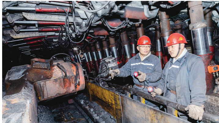
煤矿机电设备的运转状况直接影响到矿井的安全生产,图为王斌俊和他的团队成员一起下井进行设备维护。
