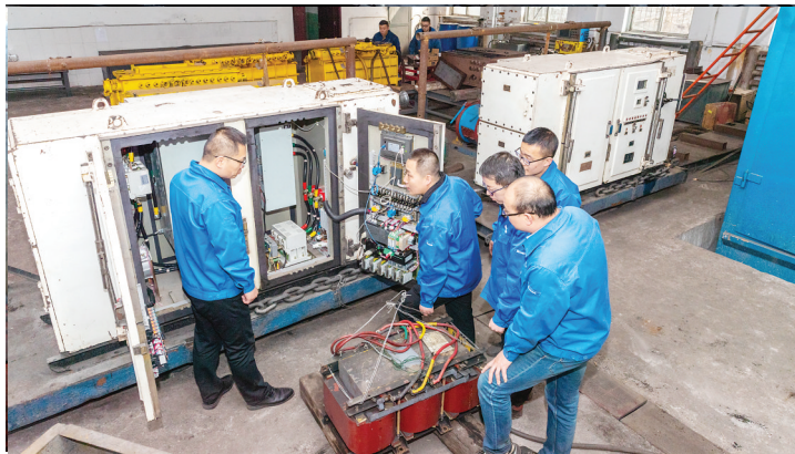
王斌俊团队攻克了20余项矿用机电设备的技术难题,在修旧、节能、维修设备方面带来直接经济效益五千余万元,间接效益超亿元。
