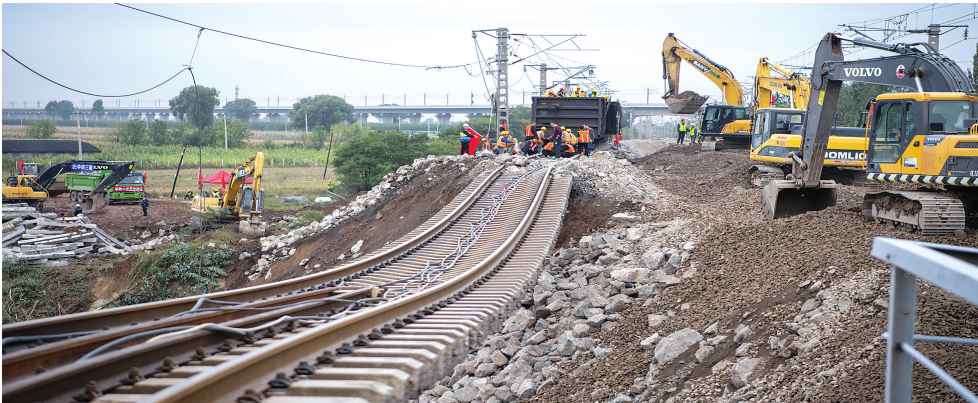
这是10月8日拍摄的南同蒲铁路昌源河大桥抢险现场。记者从南同蒲铁路昌源河大桥抢险现场了解到，10月8日21时20分，受强降雨影响中断行车的南同蒲铁路上行线（北向）实现抢通。目前，昌源河铁路桥下行线路的抢通工作仍在努力进行中。 新华社记者 杨晨光 摄
