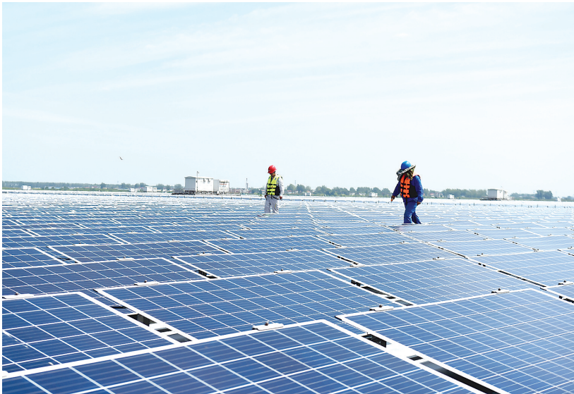
8月25日，运维人员在颍上县毛圩水上光伏电站进行巡检。近年来，安徽省阜阳市颍上县古城镇积极推进采煤沉陷区治理工作，将昔日的采煤沉陷区建设成水上光伏电站，既减少占用土地面积，又能生产清洁能源。据了解，古城镇已建成水面光伏电站并网装机容量130兆瓦，年均发电量1.36亿千瓦时，每年可节约标准煤约5.44万吨，减少二氧化碳排放量约13.56万吨。 新华社记者 黄博涵 摄
