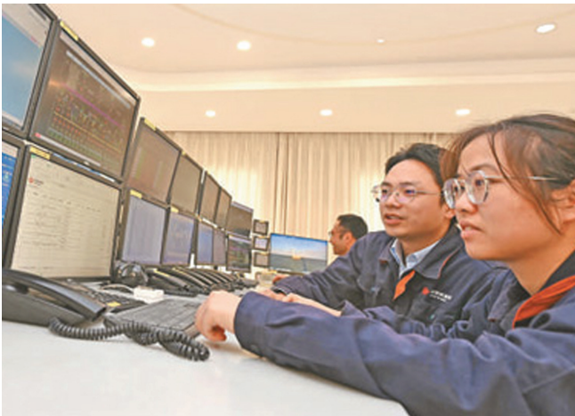
工作人员在利用数字化生产管控系统监测风力发电情况。 陈 斌摄
