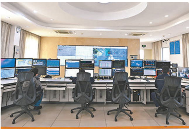
南日岛海上风电场一期项目升压站中控室内景。 陈 斌摄
