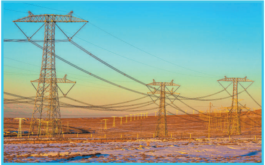
▲作为西电东送的重要通道,甘肃省张掖市积极将 “风光火”能源并网外送,保障东部地区电力供应。图为 张掖市山丹县西电东送特高压输电线路。 杨潇 摄(影像中国)
