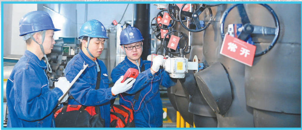
▲近年来,安徽省滁州市逐步拆除老旧小区原有的燃煤锅炉供暖,改为地热、燃气等多种清洁能源供暖,惠及数十万户居民。图为国网滁州供电公司工作人员对居民小区地源热泵装置集中采暖系统的电气设备运行状态进行检查。 宋卫星 摄(影像中国)
