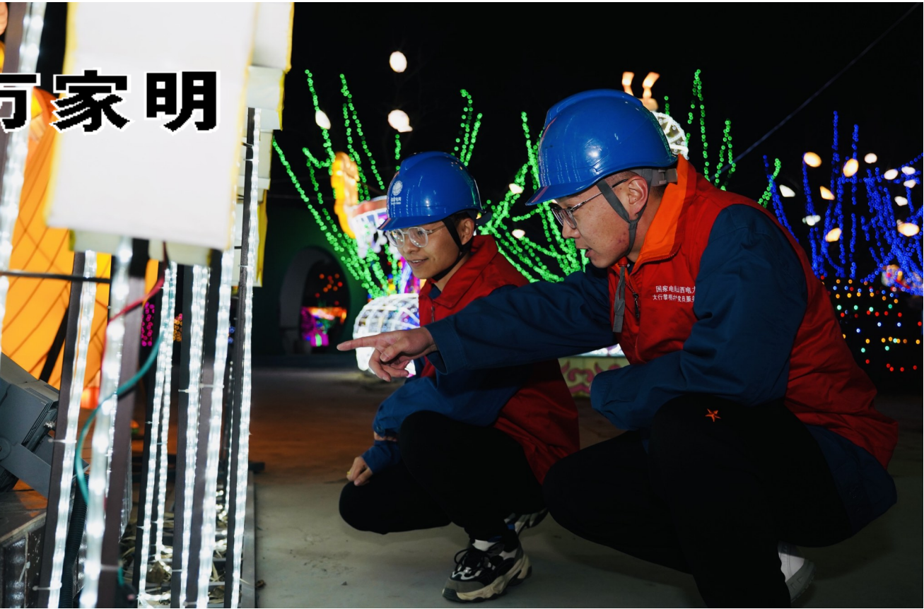
2月10日,吕梁汾阳市供电公司组织党员服务队和青年突击队员在贾家庄恐龙花灯会现场协助举办方为等展区供电线路、设备进行全方位检查
