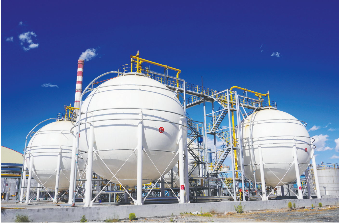
东锦肥业合成氨储存装置
