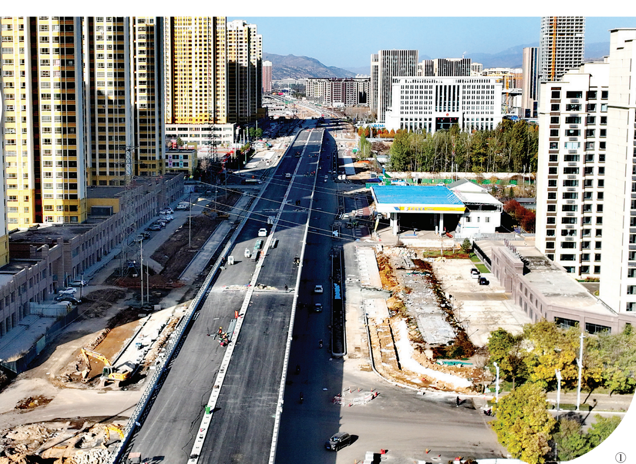
图①为已经成型的新安大道。图②为工人们正在浇筑筑路隔离带的场景。
