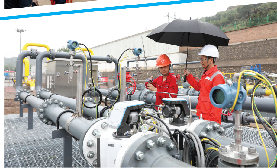
图为兴县煤层气并网现场。张亚东 摄
