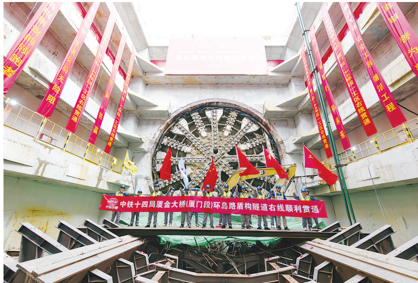
3月4日,中铁十四局施工人员在厦金大桥(厦门段)环岛路右侧隧道贯通现场合影庆祝。3月4日,厦金大桥(厦门段)环岛路右侧隧道完成盾构掘进,顺利贯通。厦金大桥(厦门段)主线长约17.34公里,由海上桥梁和陆地隧道两部分组成。新华社记者 魏培全 摄
