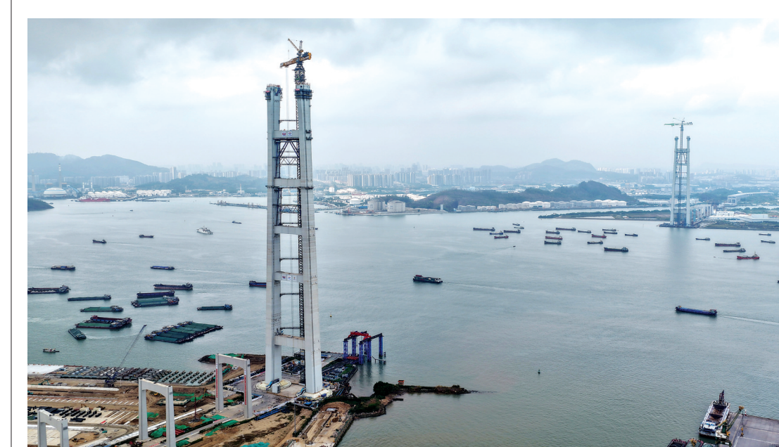
3月22日,粤港澳大湾区狮子洋大桥核心区桩基工程顺利转入上部结构施工。新华社记者卢汉欣摄
