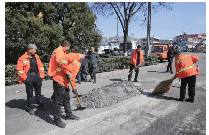
春回大地,冰冻消融。春季是国省干线路面病害高发期,更是公路养护的关键时期。为了及时处置路面病害,确保路况质量稳定,保障交通运输安全,离石公路局开展了春季干线公路病害处置攻坚战,从3月12日开始对国道209线离石境内进行路面病害集中处置,该路段共20余公里,每天出动作业人员10余人,铣刨机一台、三轮车两台、再生机一台,备有青灌缝胶10吨,集中进行坑槽修补和龟裂灌缝,截止目前共处置路面坑槽约600余平米、沥青灌缝约4万余米。通过这次路面病害集中处置使我区干线路况和交通运输安全得到了明显提升,更好地为地方经济和民生服务。
