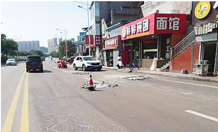
柳林县城区部分路段窞井盖破损、松动
