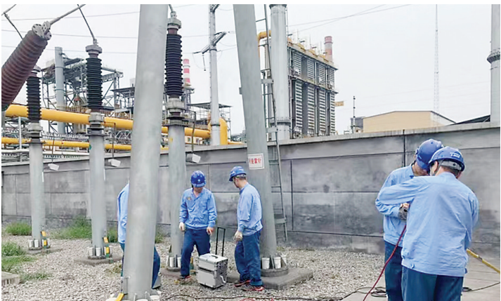
王屯站王东间隔送电前接触电阻导通试验
