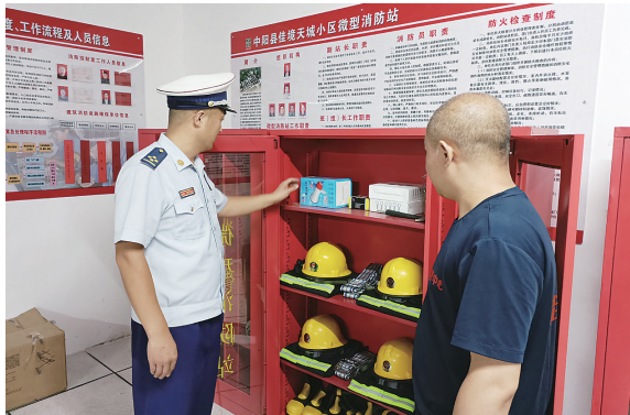
检查微型消防站设备
