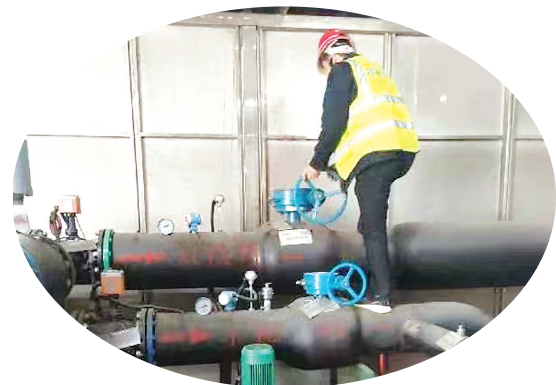
南门外供水站工作人员在补水
