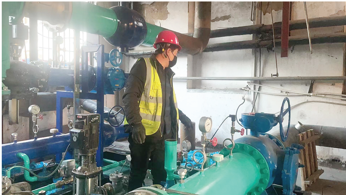
工作人员在检查供暖设备阀门
