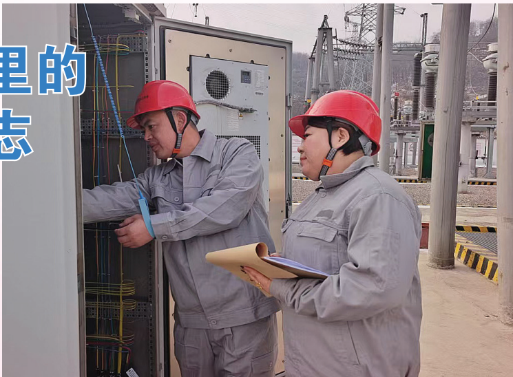
电力员工正在巡检设备 孔晓瑞 摄
